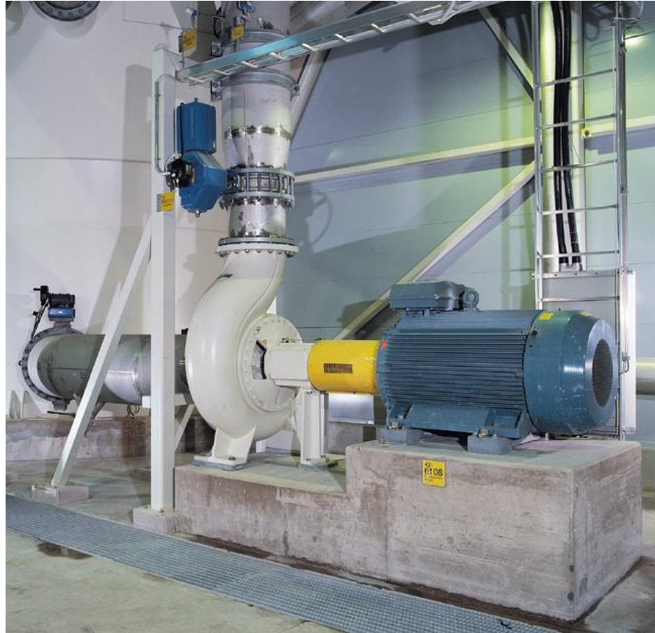
مضخة بمحرك كهربائي
