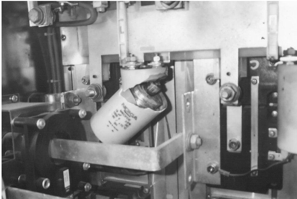
Capacitor failure (Courtesy of ABB Inc.) عطل في المكثف
