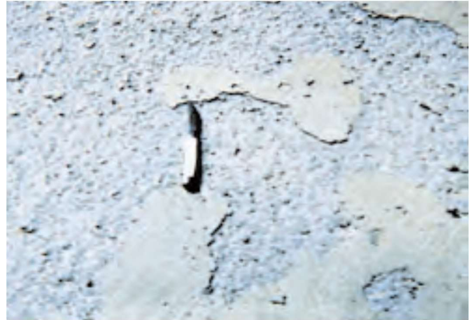
تقشر سطح الخرسانة نتيجة عدم استخدام مولدات الفقاعات ضمنها، عند تعرضها لأملاح الازابة.
