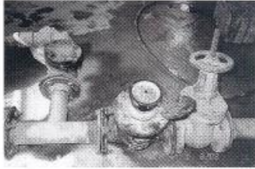
الشكل (١٠) عداد مياه مركب في محطة ضخ بصورة مغلوطة
