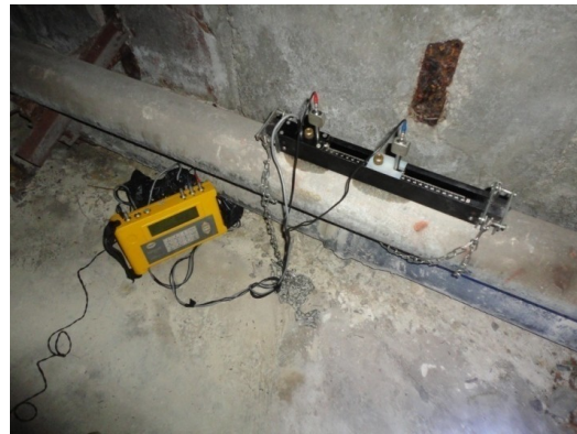
الشكل (4) تركيب العداد الفوق الصوتي (Ultrasonic) على مدخل الشبكة
