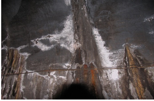
الشكل (6) شقوق وتسريب مياه وتمليح في القوس [6]
