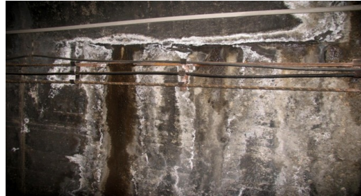
الشكل (5) شقوق وتسريب مياه في الجدار اليميني من النفق [6]
